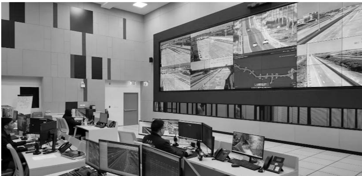
รูปที่ 6-21 ตัวอย่างห้องระบบปฏิบัติการข้อมูลและศูนย์ควบคุมทางหลวงพิเศษระหว่างเมือง
